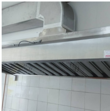
อุปกรณ์ระบายอากาศ เครื่องดูดควัน
