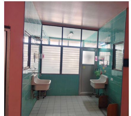
อ่างฟอกมือชนิดที่ไม่ ใช้มือเปิด/ปิดน้ำ
