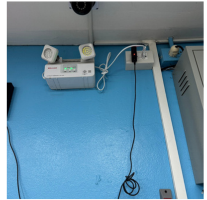
ระบบไฟฟ้าและแสงสว่างสำรอง
